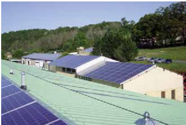
Ténésol, site de Socave – 761 kWc – Installation sur bâtiments agricoles
