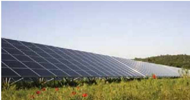
Solairedirect 2 : Solairedirect, site de Vinon sur Verdon – 4,3MWc Installation en plein champ
